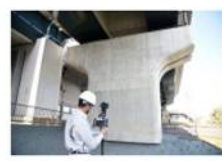
AIひび割れ解析ソリューション
